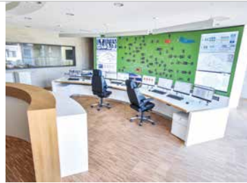
In der Leitwarte können die Anwender jederzeit eingreifen
