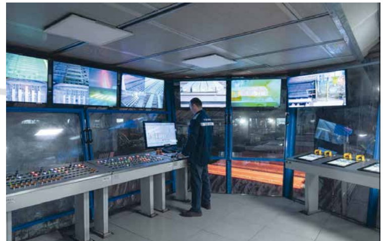
In den Leitständen (hier der Stranggießanlage) werden die Produktionsprozesse zentral überwacht
