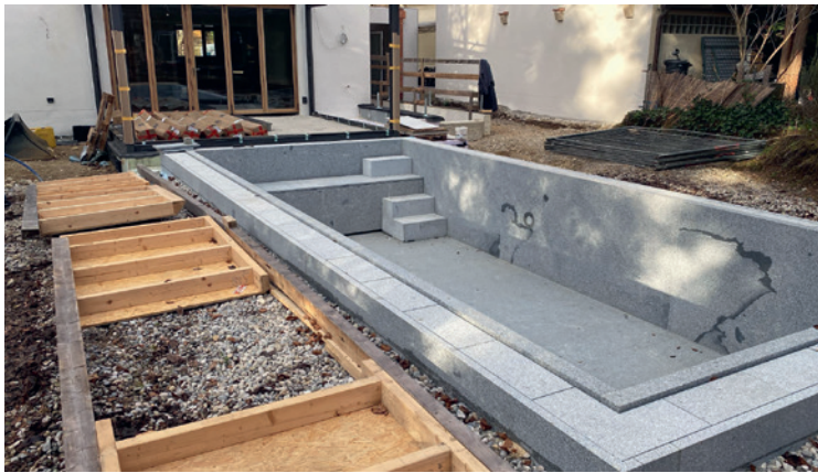
Heckmeier arbeitet zu 80% für Privatkunden. Schwimmbadtechnik bildet dabei eine wichtige Säule
