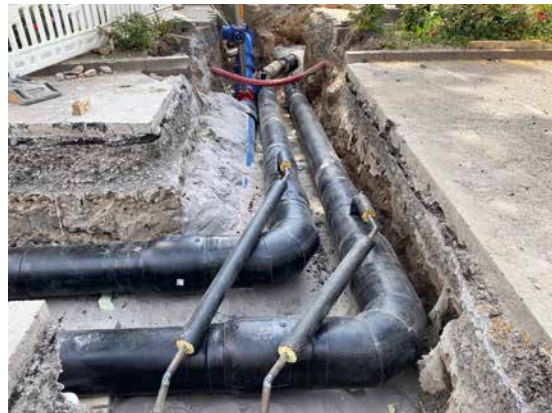
Der Ausbau der Fernwärme bringt in den nächsten Jahren einige Baustellen mit sich
