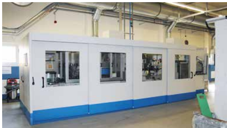
LK Metallwaren bietet durchdachte Lösungen bis ins Detail, hier F10 Schallschutz an einer Werkzeugmaschine mit Schiebetüren
