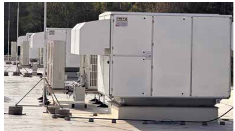
LK Lüftungsanlage REKU 10 mit Wärmepumpen
