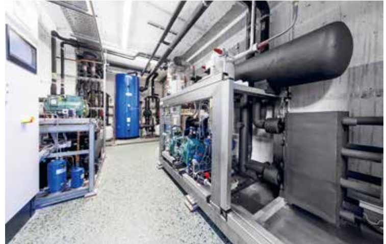
Die Stärke von Kälte Eckert liegt in der Realisierung sowohl von wirtschaftlichen als auch umweltschonenden Anlagen durch die Verwendung natürlicher und umweltschonender Kältemittel
