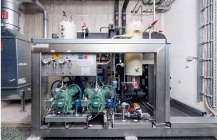
Kälte Eckert plant und installiert Kälteanlagen in jeder Größe und mit unterschiedlichen Technologien
