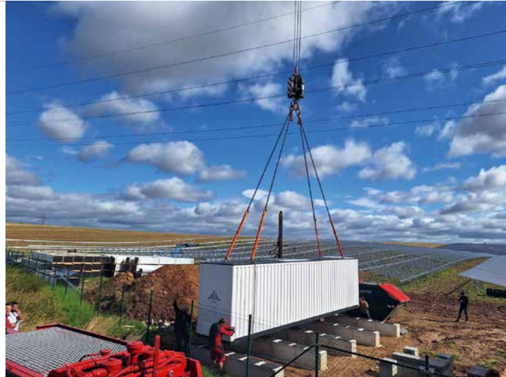
SUNTEC deckt sämtliche Bereiche ab, hier ein Großspeicher mit 5.500 kWh
