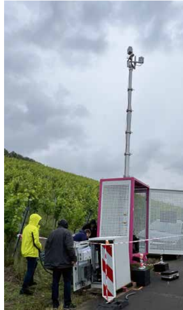
Gemeinsam mit der Universität Koblenz stattete GIMBEL CONSULTING einen Weinberg mit einer modernen 5G-Infrastruktur aus
