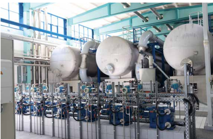
Präzise abgestimmte Rohrsysteme für sensible Prozesse: DSD Industrie Rohrtechnik realisiert komplexe Anlagenlösungen in der Wassertechnik mit hoher technischer Kompetenz
