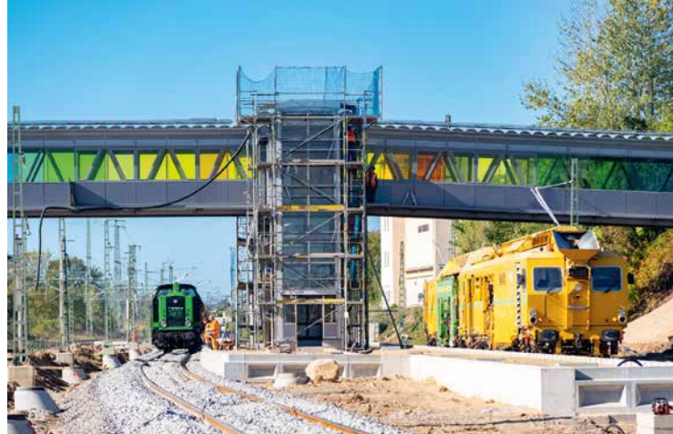
Am Bahnhof finden umfangreiche Maßnahmen zur Erneuerung und Weiterentwicklung der Infrastruktur statt – unter Einsatz moderner Technik und spezialisierter Verfahren
