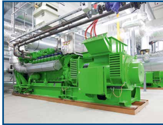
Die BHKW-Anlage der Uniklinik Köln: Ein zentraler Baustein auf dem Weg zu Effizienz und Dekarbonisierung
