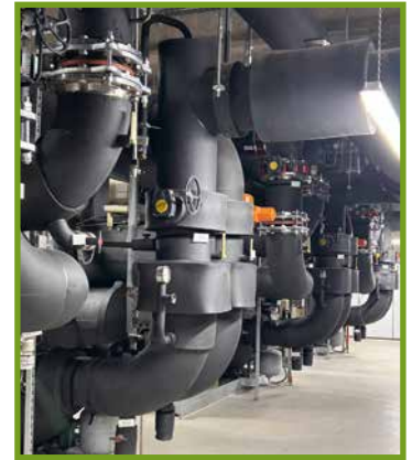
Die Kälteanlage sorgt für stabile Temperaturen und sichere Klinikprozesse
