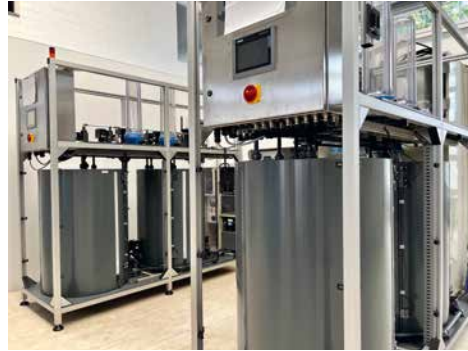
Anlagen zur Herstellung und Dosierung des Wirkstoffs Chlordioxid
