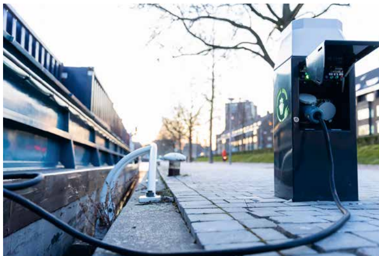
Mit modularen Energiestationen...
