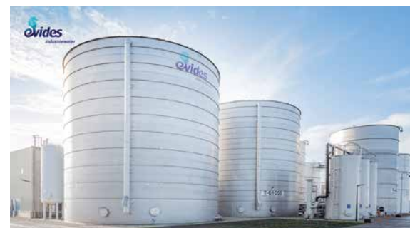
Zentrale VE-Wasseraufbereitungsanlage im Hafen von Rotterdam, Niederlande
