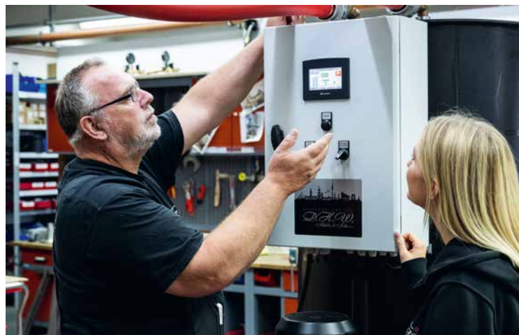
'Smart': eine Feuerschutzanlage, die bei Ladestationen für E-Autos zum Einsatz kommt, ist eine Neuentwicklung der Abteilung Feuerschutz, dem drittgrößten Bereich bei D.H.W.
